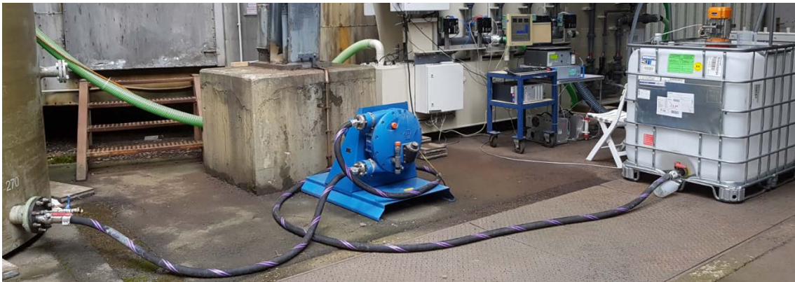
Abb. 22: Schlauchpumpe zur Rückführung der Kalk- bzw. Kreidesuspension in den IBC-Container
