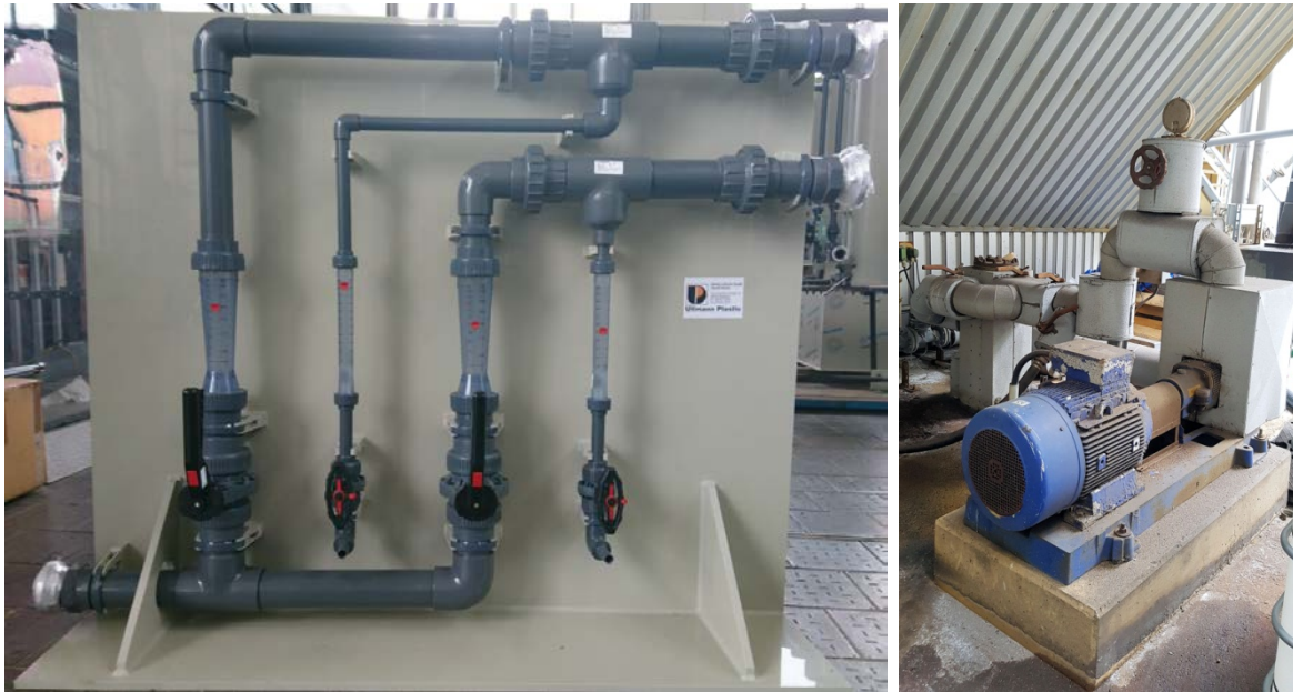
Abb. 23: Mischstation (links) und kraftwerksseitig fest installierte Hochleistungs-Kreiselpumpe (rechts)
