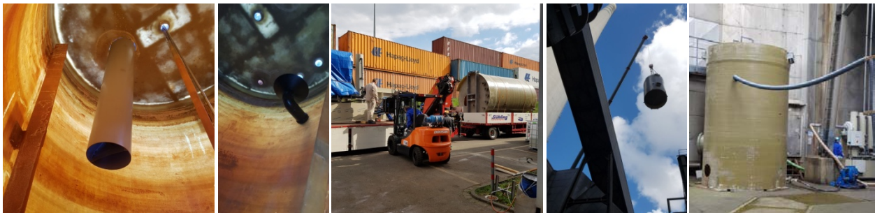
Abb. 24: Dortmundbrunnen – v.l.n.r.: Tauchrohr, Klarphasenüberlauf, Anlagentransport nach Wilhelmshaven, Krantransport im Kraftwerk, Standort im Kraftwerk
