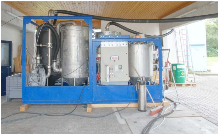
Abb. 9: Praxisversuchsdurchführung mit Abgasen eines BHKW-Motors eines Klärwerks
