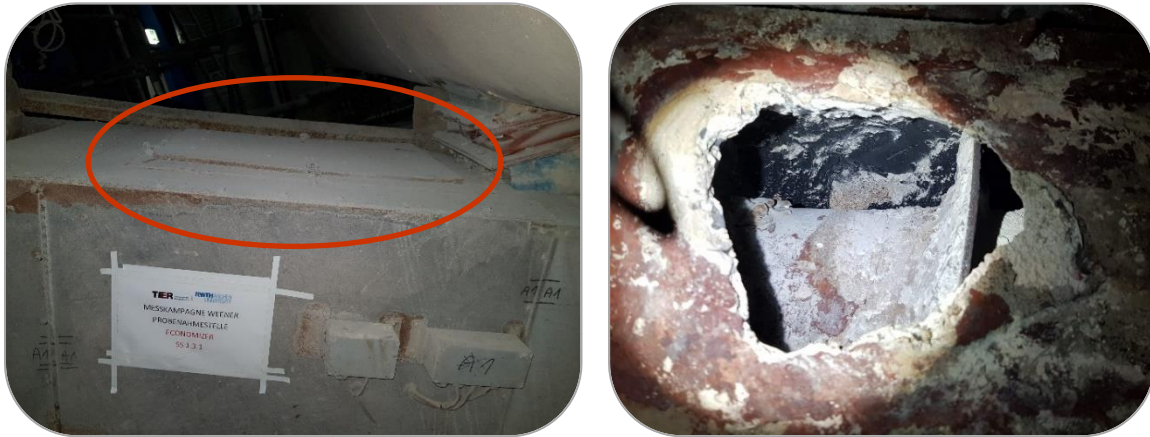
Abbildung 6.10: Probenahmestelle SS 1.3.1 zur Entnahme von Feststoff unterhalb des Economizers (links), im Betrieb freigelegte, leere Schnecke (rechts).
