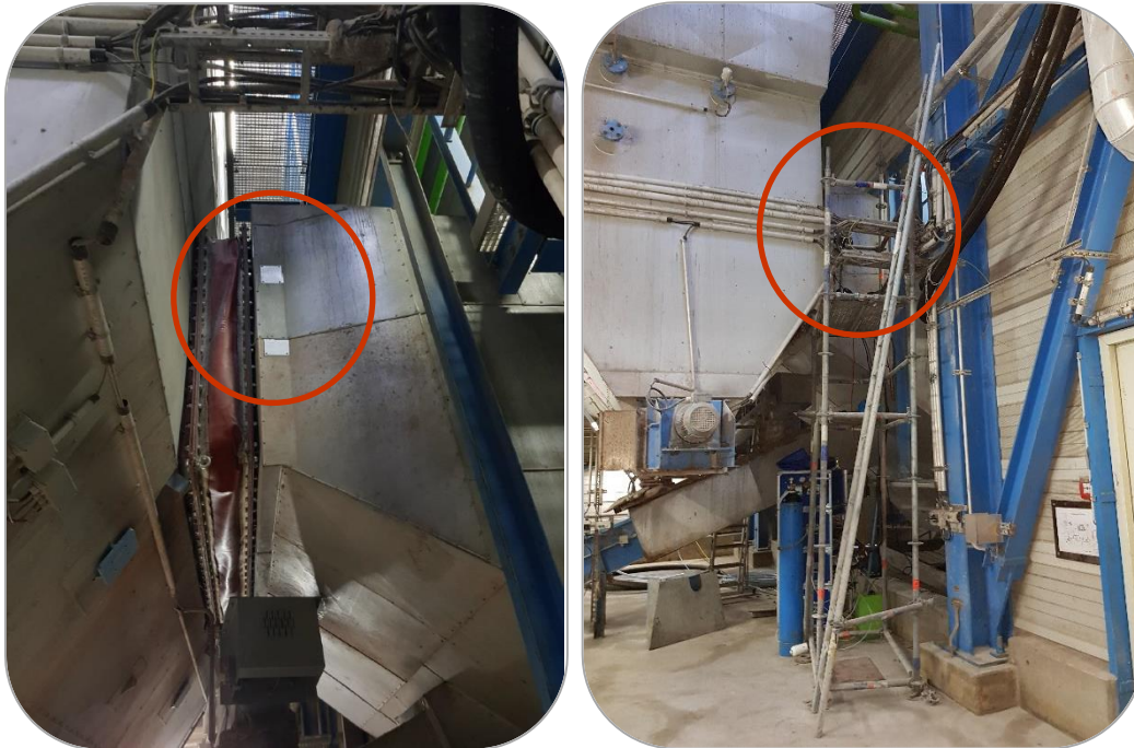
Abbildung 6.8: Position der Eco-Gasmessung (Gas 1.3.1) zwischen Austritt Economizer und Stufe 2 der Rauchgasreinigung.
